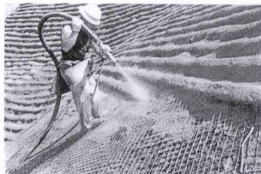
b) Bảo vệ bằng phương pháp phun bê tông có lớp lưới thép phủ mặt
